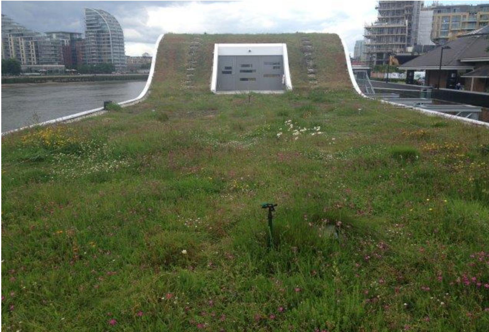
Cubierta vegetal ecológica en edificio sobre el río Támesis . Londres. Fuente: autor.
